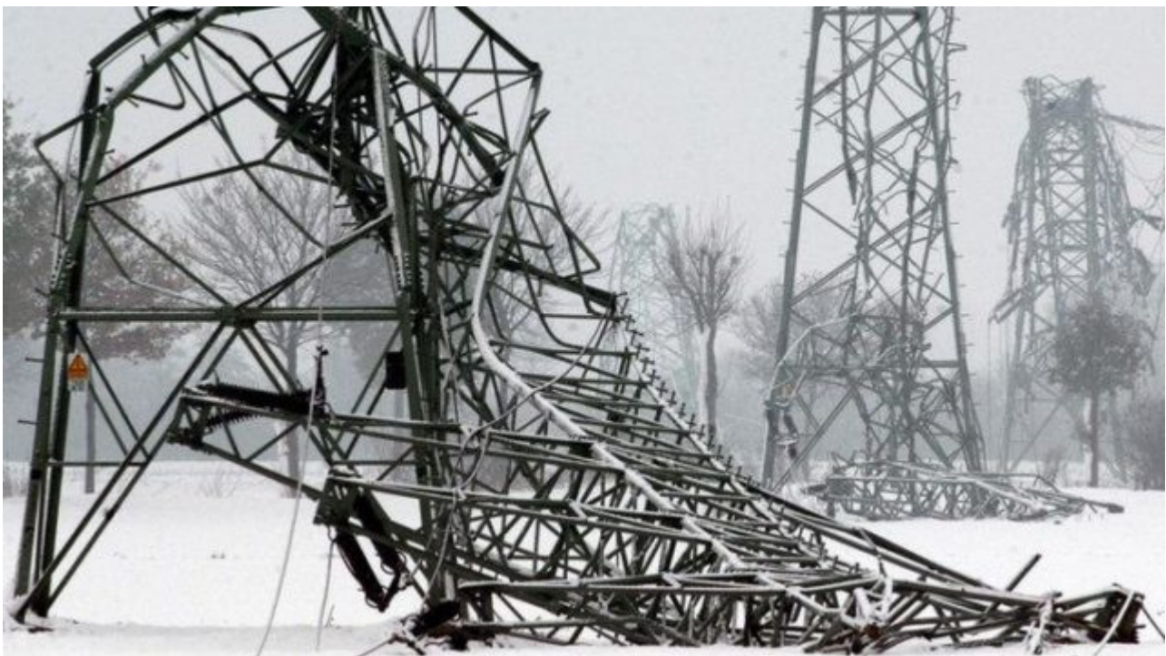
Bild 6: Typisches Schadensbild an den vom Eis überlasteten Hochspannungsmasten im Münsterland 2005 (Quelle. WDR)
